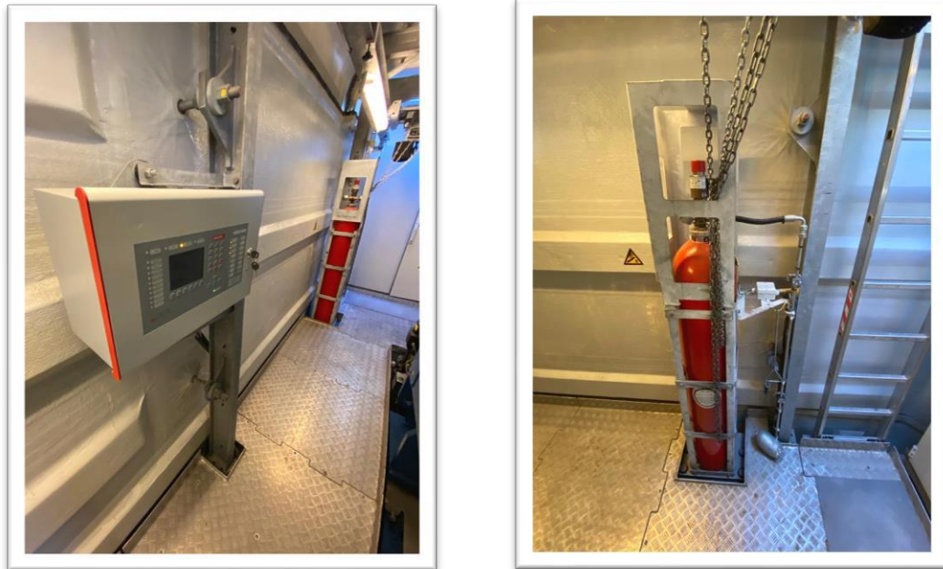
Şekil 5.43 Nasel için Yangın Söndürme Sistemi
